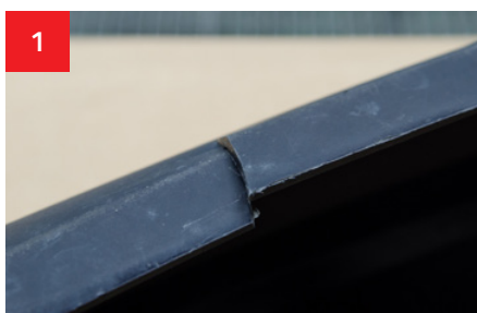
Begutachtung der Beschädigung sowie Auswahl der geeigneten Reparaturtechnik.
